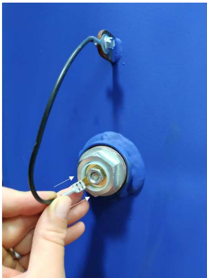
figuur 5 - Aansluiting van de kabel van de anode versie (B) op het lipje van de anode
